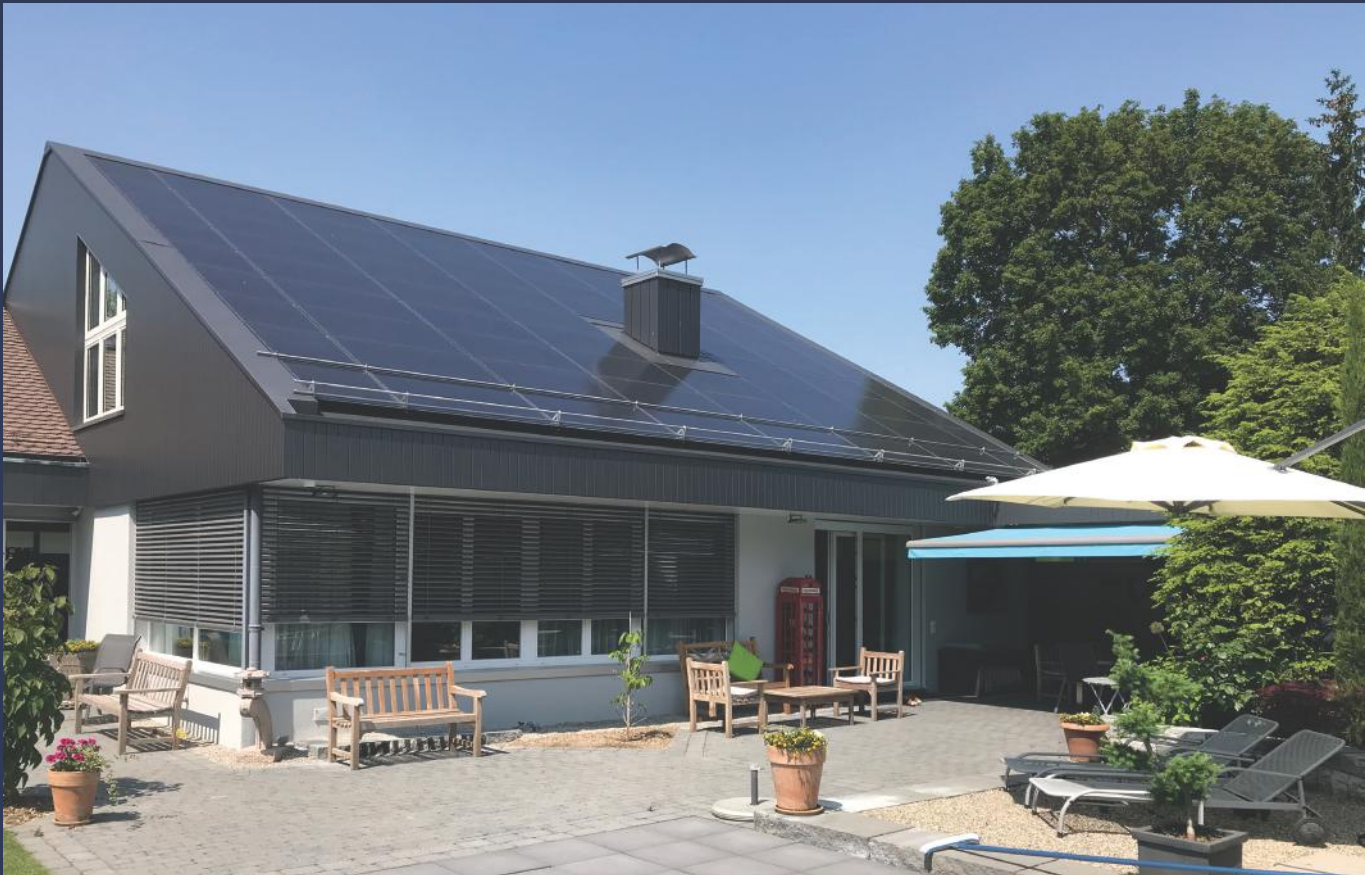
Indachanlage auf Wohnhaus | Planung & Realisierung: swisscarport.ch®
