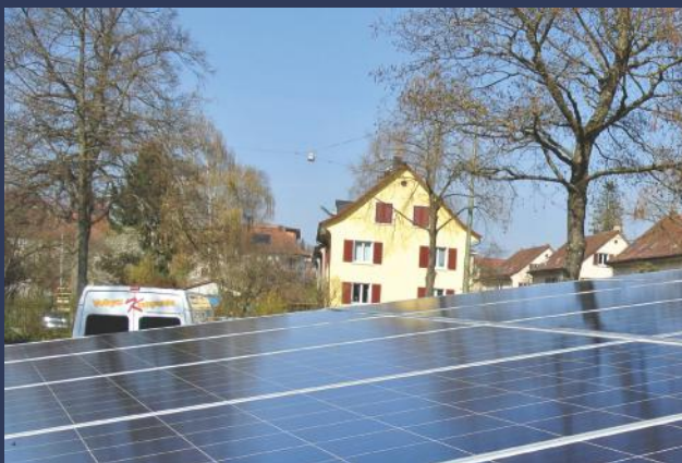
Photovoltaik-Anlage Smartport Planung & Realisierung: swisscarport.ch®
