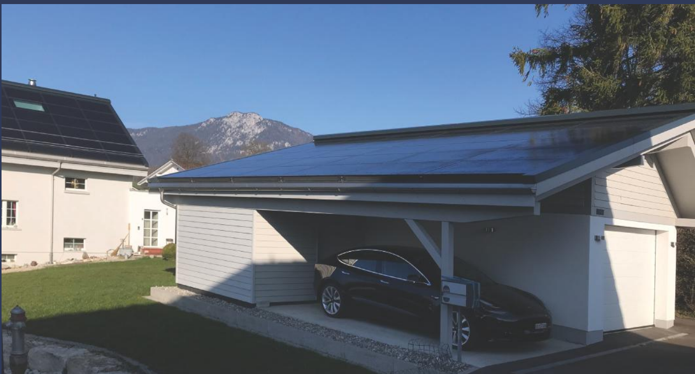
Indachanlage auf Garage und Wohnhaus | Planung & Realisierung: swisscarport.ch®
