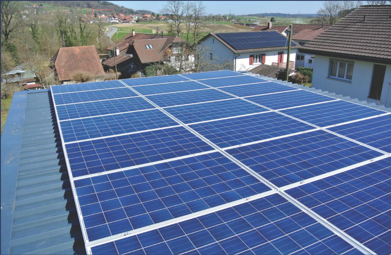
Photovoltaik-Anlage Smartport | Planung & Realisierung: swisscarport.ch®
