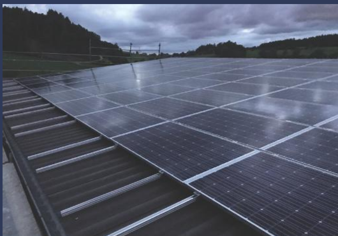
Aufdachanlage auf Scheune | Planung & Realisierung: swisscarport.ch®
