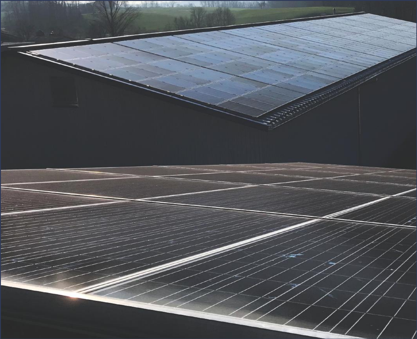
94 kWp - Anlage auf Gewerbehalle | Planung & Realisierung: swisscarport.ch®
