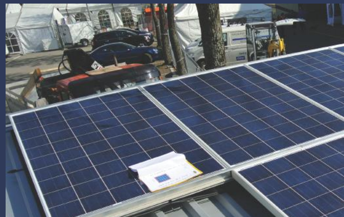
Photovoltaik-Anlage Smartport Planung & Realisierung: swisscarport.ch®
