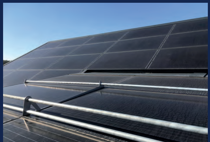
Indachanlage auf Schulhaus | Planung & Realisierung: swisscarport.ch®
