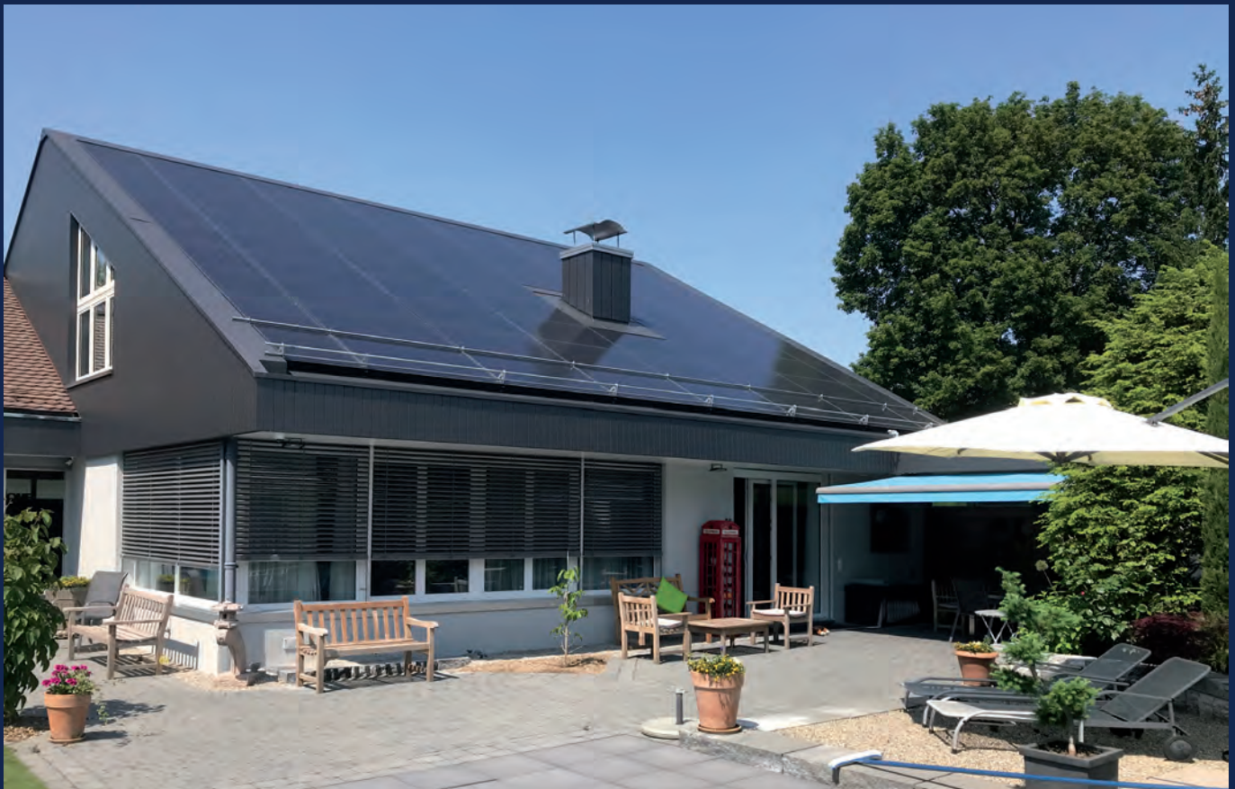
Indachanlage auf Wohnhaus | Planung & Realisierung: swisscarport.ch®
