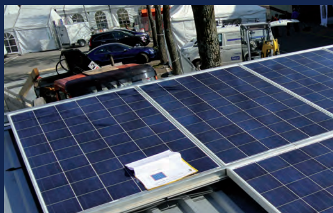
Photovoltaik-Anlage Smartport Planung & Realisierung: swisscarport.ch®
