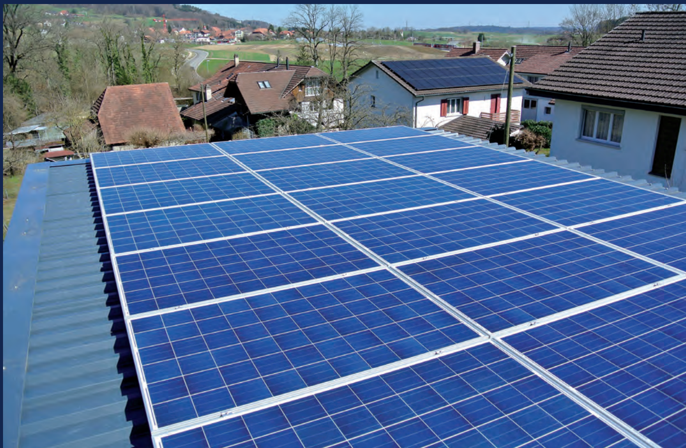
Photovoltaik-Anlage Smartport | Planung & Realisierung: swisscarport.ch®
