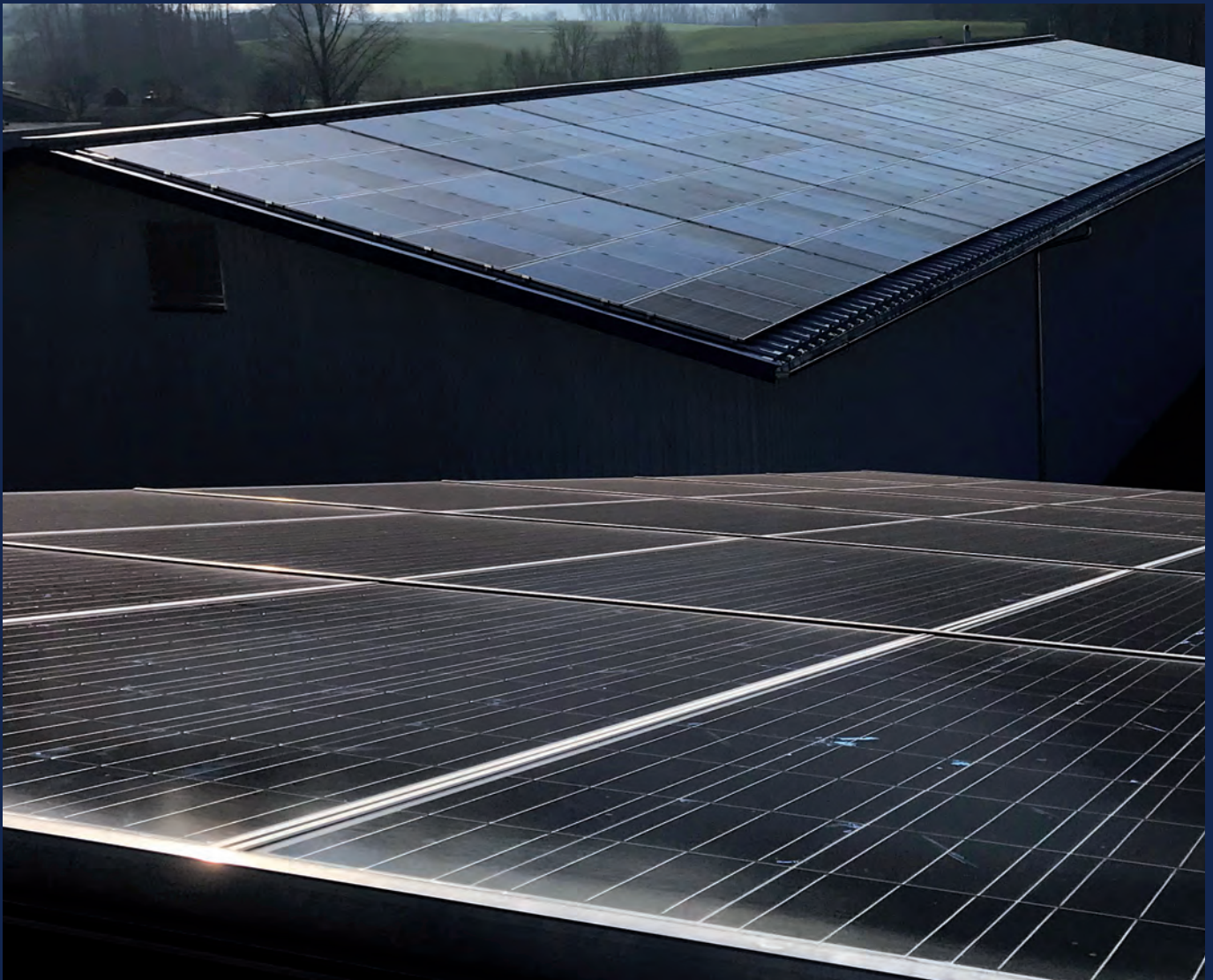
94 kWp - Anlage auf Gewerbehalle | Planung & Realisierung: swisscarport.ch®
