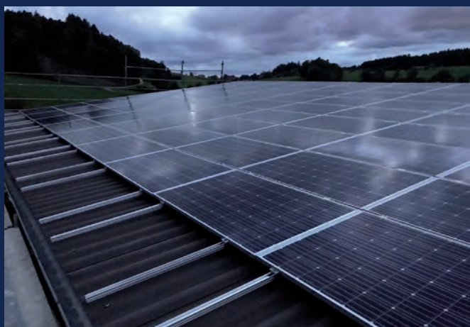
Aufdachanlage auf Scheune | Planung & Realisierung: swisscarport.ch®
