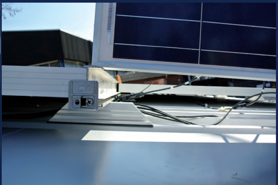
Details Solarsmartport I Planung & Realisierung: swisscarport.ch®
