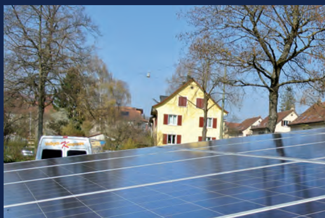
Photovoltaik-Anlage Smartport Planung & Realisierung: swisscarport.ch®
